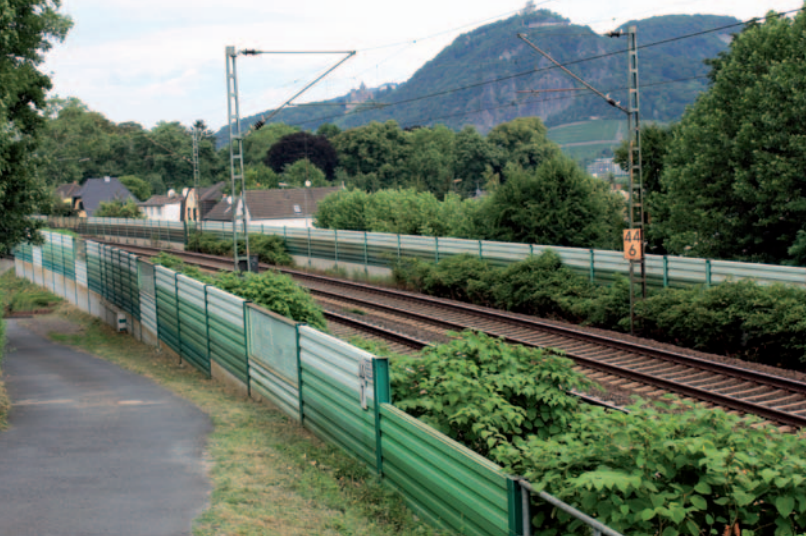
Schallschutzwände in Rolandswerth
